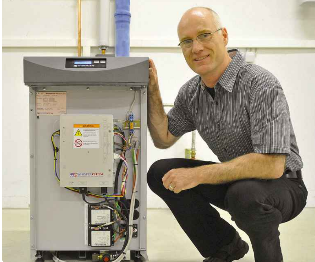
Selbst Energie erzeugen – mit einem Mini-Blockheizkraftwerk im eigenen Keller geht das
