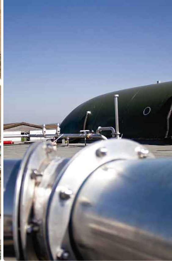
Unter der Haube liegt der Gasspeicher
