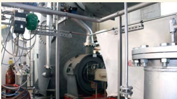
Turbine und Generator
